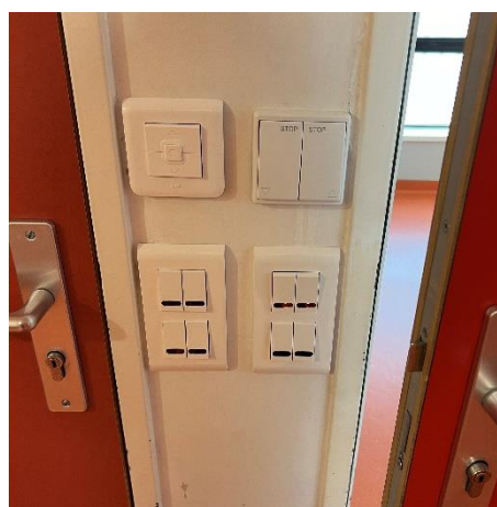
Interrupteurs dans le sas
