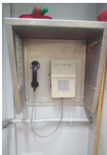
Point-phone au bâtiment C
