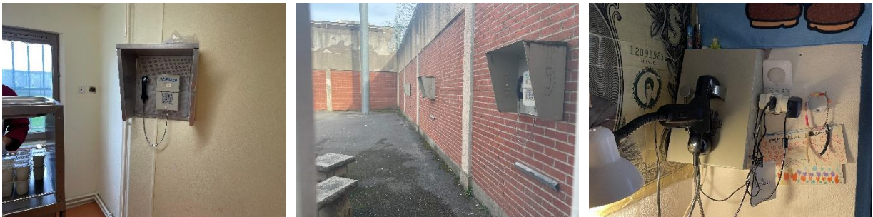
Appareils téléphoniques en coursive, en cour de promenade et en cellule
