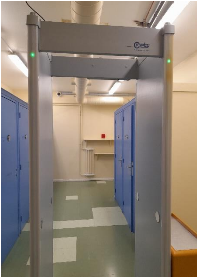
Portique de sécurité et cabines de fouille des parloirs
