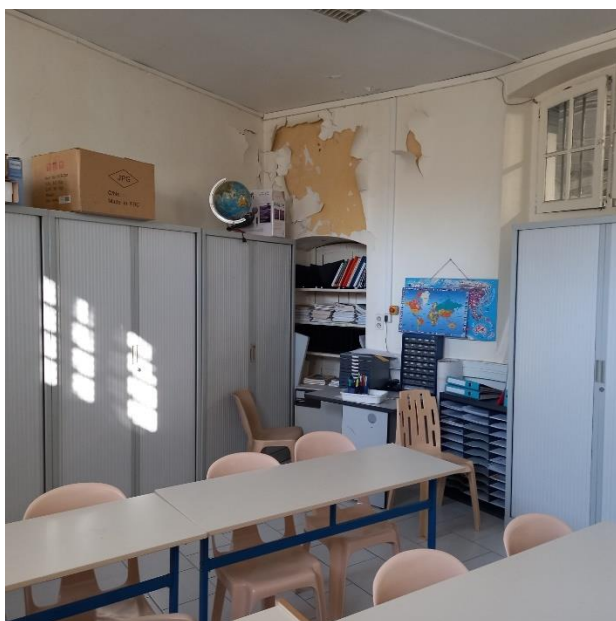
Vue sur la peinture dégradée recouvrant les murs de la salle de classe
