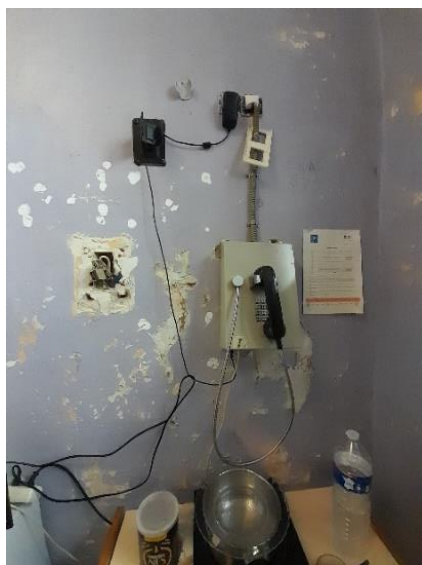
Prise à nue et mur dégradé
