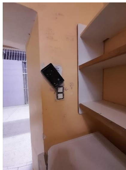
Système d'interphonie inexistant, support d'accroche arraché et interrupteur pour la lumière sans protection
