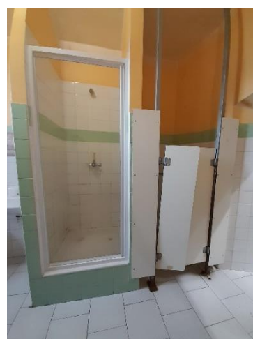
WC séparé avec une porte battante à mi-hauteur et bancale
