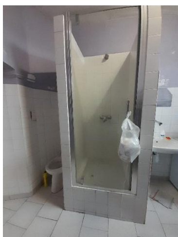
WC sans dispositif de séparation
