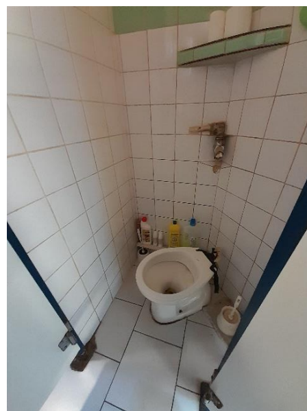
Chasse d'eau qui ne fonctionne plus
