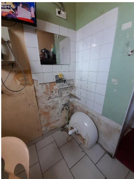
Lavabo cassé, laissé à même le sol
