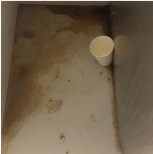
Etat de saleté du sol du local sanitaire le long des WC
