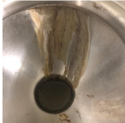
Etat de saleté de la cuvette des WC du local sanitaire
