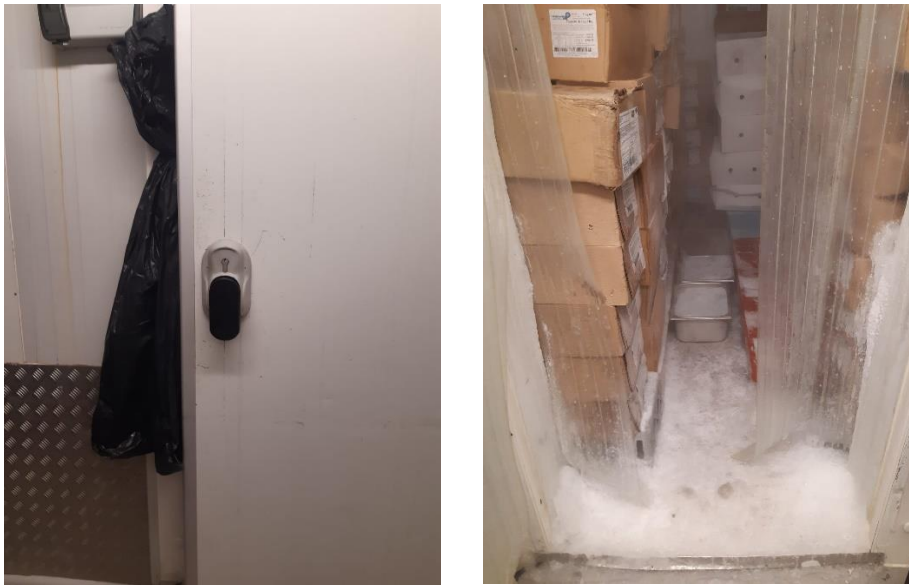
Porte endommagée et intérieur givré de la chambre de congélation
