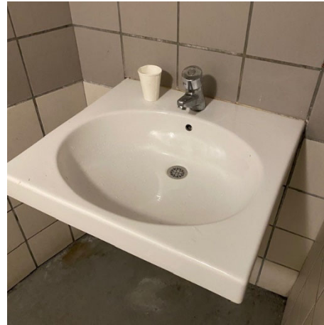
Lavabo du bloc sanitaire situé dans le couloir des geôles
