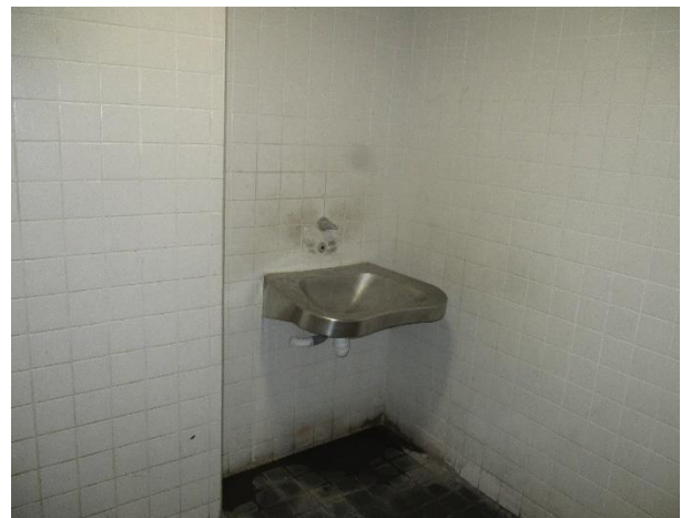
Le lavabo du local sanitaire des cellules collectives
