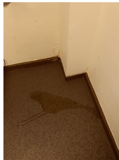
Infiltration d'eau en salle de consultation
