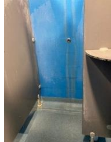
Les cabines de douche de D2
