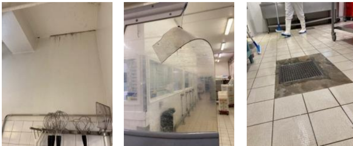
Les anomalies constatées dans la cuisine
