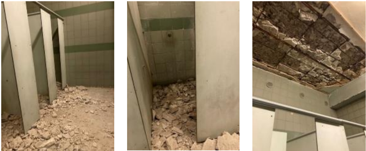
Les cabines de douche condamnées de D1
