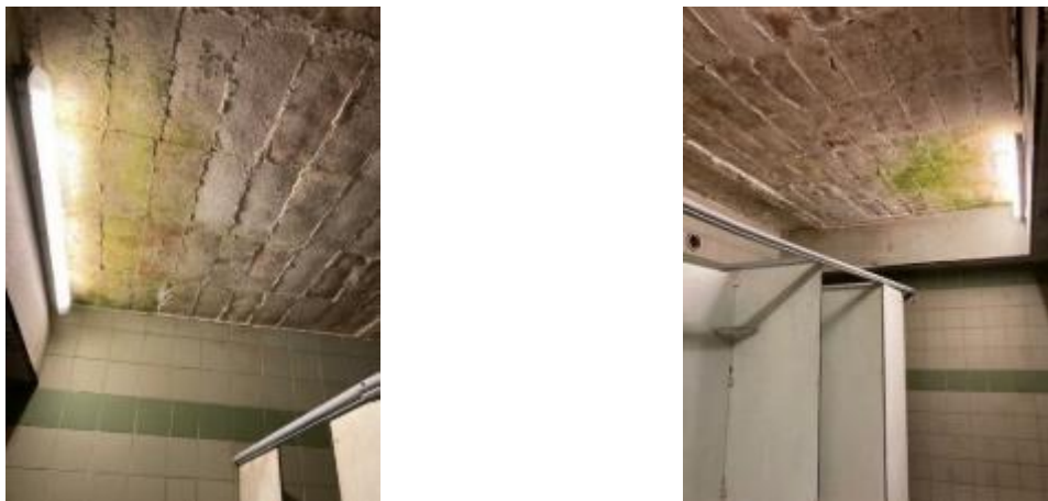
Plafond du local de douche au 3 ème étage de D1
