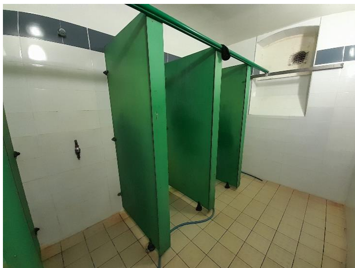
Douches du 1 er étage
