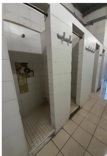
Cabines de douches de la salle de sport
