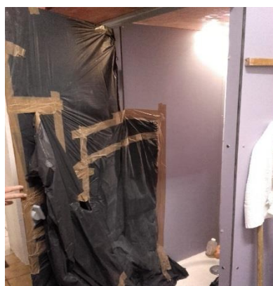
Protection bricolée sur une porte de douche
