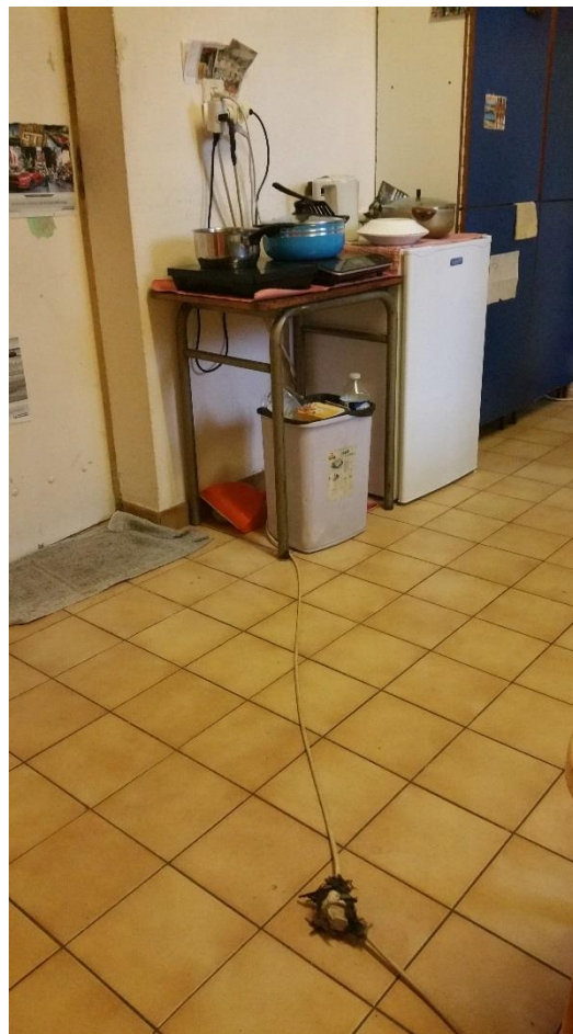
Installation électrique à partir de l'unique prise de courant
