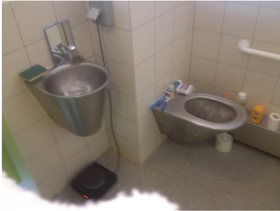
L'absence de production d'eau chaude a conduit l'un des occupants d'une des deux cellules à mobilité réduite à glisser sous le lavabo, une plaque chauffante.
